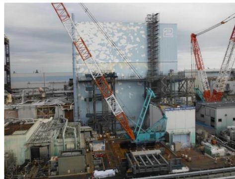
2号機 原子炉建屋の状況
