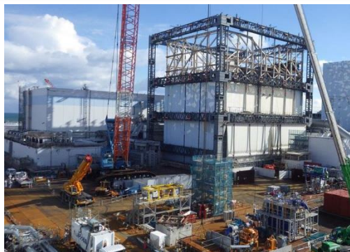
1号機 原子炉建屋の状況
